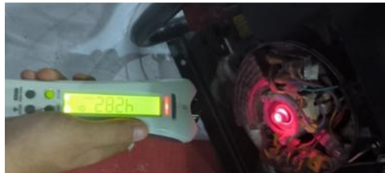
Gambar 9. Pengujian Tanpa Beban Generator Set
