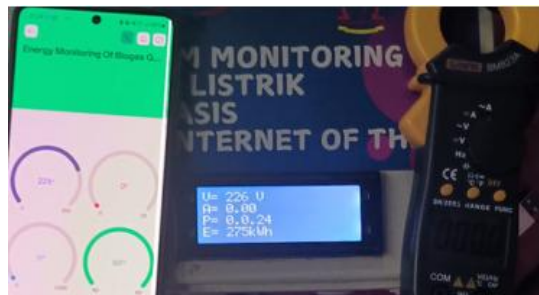
Gambar 10. Pengujian Tanpa Beban Generator set membandingkan monitoring daya listrik IOT dan Amperemeter
