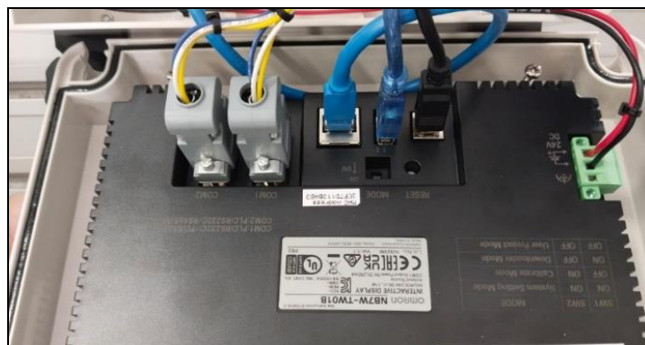
Gambar 4. Sambungan Pengkabelan ke HMI
