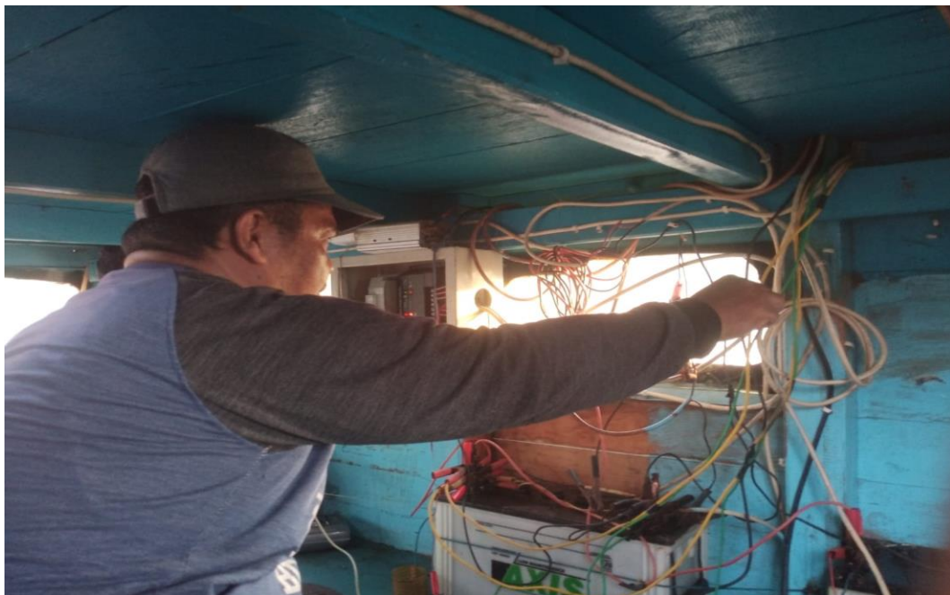
Gambar4. Proses Perakitan Dan Pemasangan Control Untuk Menghasilkan Listrik Baik AC maupun DC
